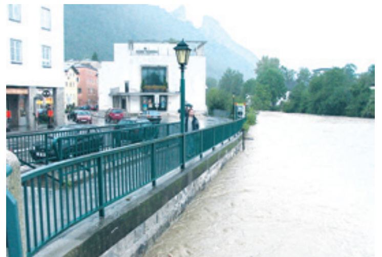
Dem Hochwasserpegel hielt die Uferbefestigung am 12. August 2002 nicht überall stand, wie hier am Kinovorplatz. Bilder Frauenhuber
